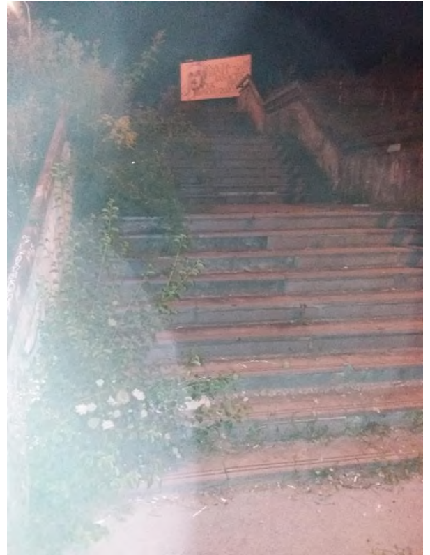
Obrázek 14: Vedle podchodu u zastávky MHD Novolišeňská (směrek k trolejbusové zastávce směr Jírova) je velmi poškozené a zarostlé schodiště.
