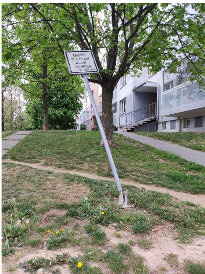
poškozená patka značky na ul. Molákova
