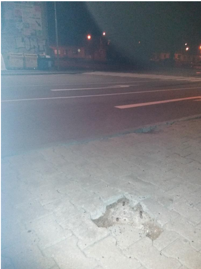
foto 1: zastávka nám. Karla IV. – část chybějící dlažby
