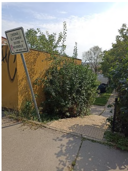
Obrázek 22: Mezi ulicemi Víkova a Strnadova je dlouhodobě špatný stav schodů (uvolněné dlaždice).
