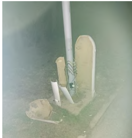
Obrázek 2 – čerstvě rozbitý kryt lampy el. osvětlení vedle domu Bartákova 13.
