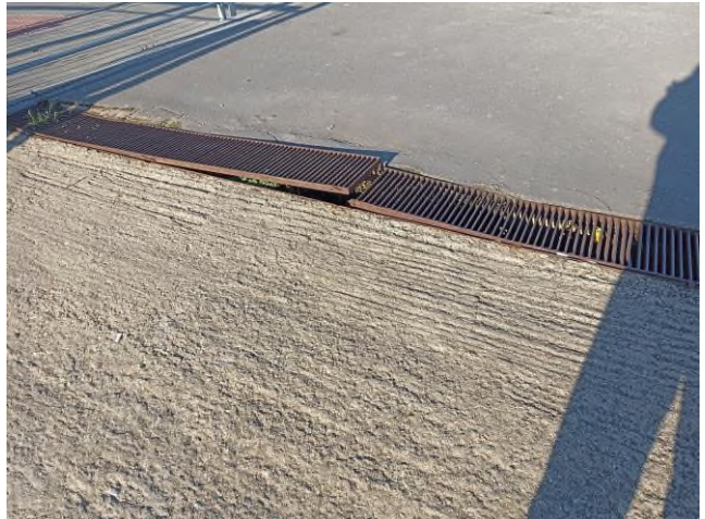
Obrázek 17 – Novolíšeňská u stejnojmenné zastávky tramvaje – ohnutá mřížka uprostřed chodníku
