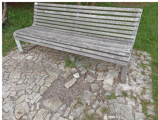
Obrázek 19: Trnkova park – poškozené dláždění
