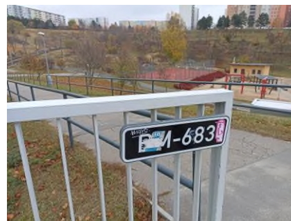
foto 15: poškozené označení mostu nad zastávkou MHD kotlanova
