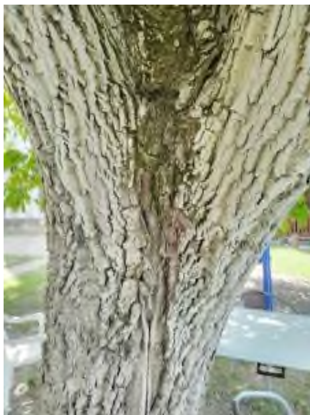
Ořešák č. 6 pohled na rozvětvení a podélnou prasklinu
