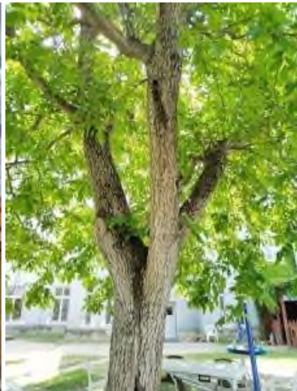
Ořešák č. 6 pohled na kosterní větvení a podélnou prasklinu
