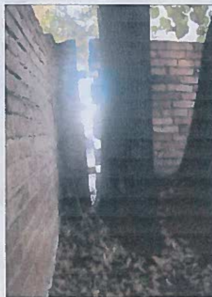
Poškozená zeď lípami č. 9 a 10
