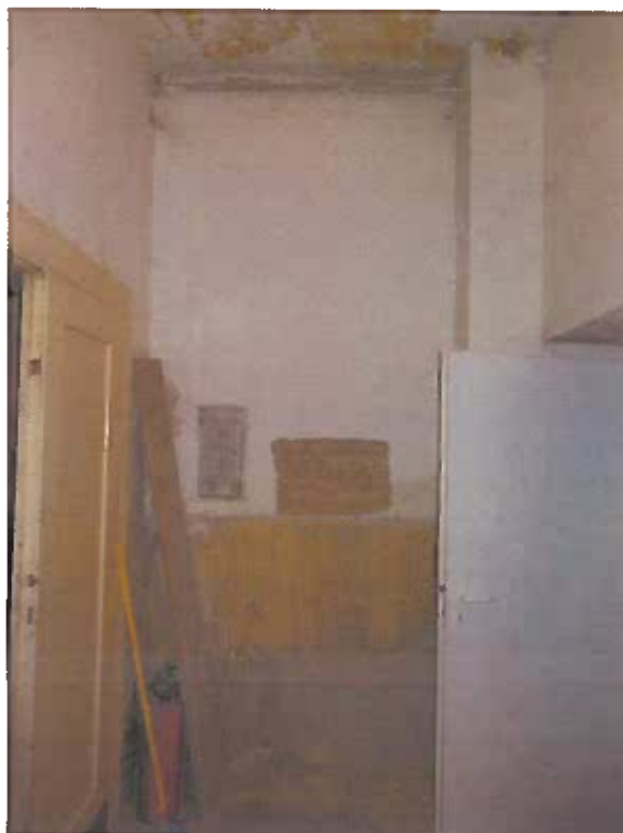
Obr. 35 Místnost č. 116, vlhká zeď a vlhkostní mapa na stropě (vyschlá).
