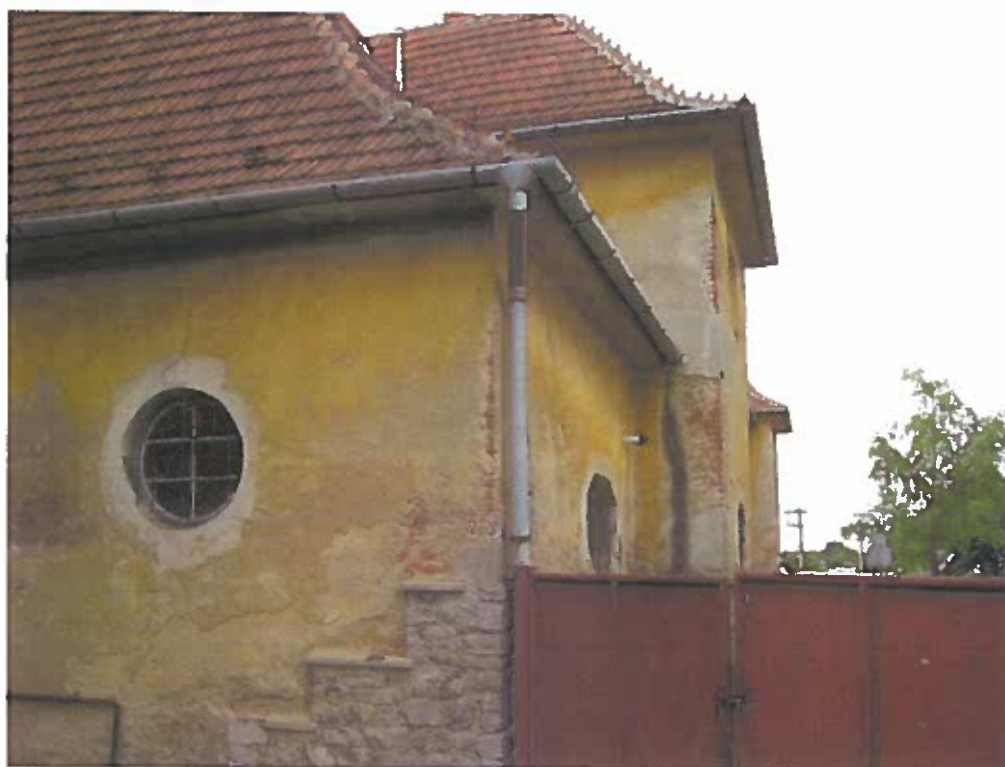
Obr. 18 Detail rohu orlovny ze Dvora (trhlina nad kulatým oknem).
