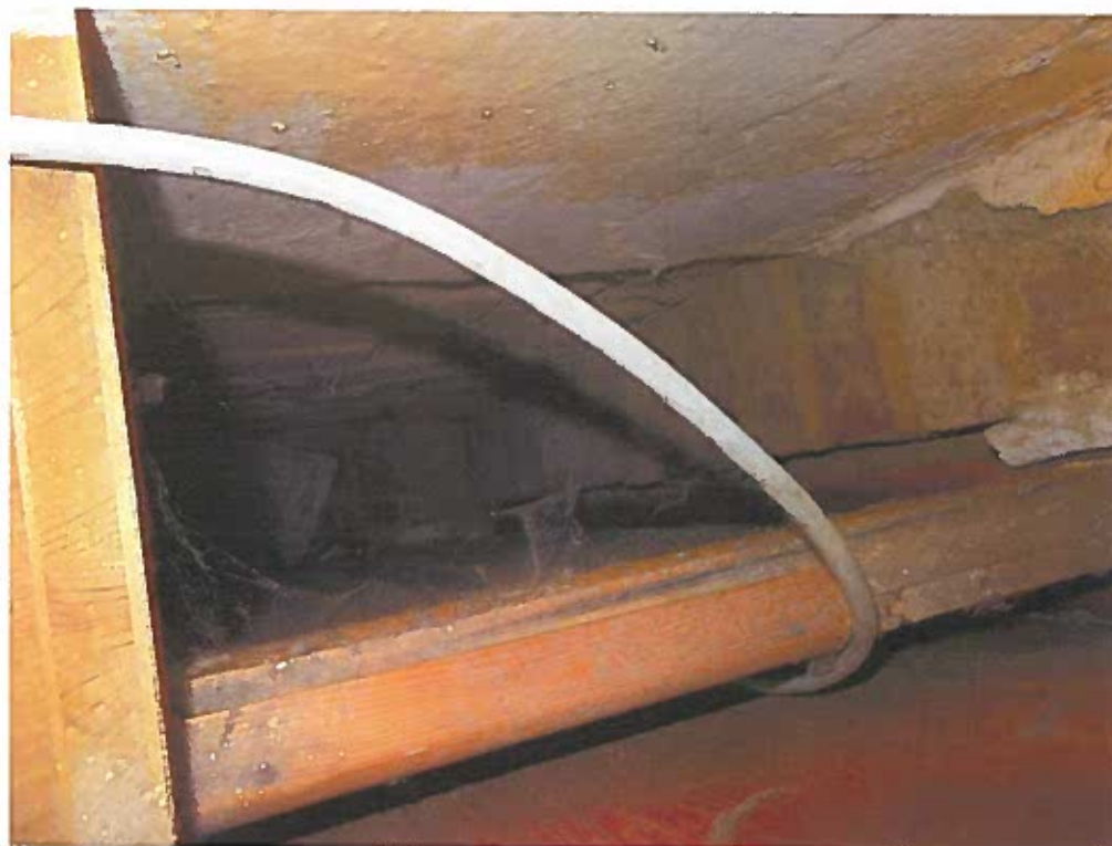
Obr. 90 Vlhkot za dřevěným obkladem - Šatna Effeta, m.č. 04.
