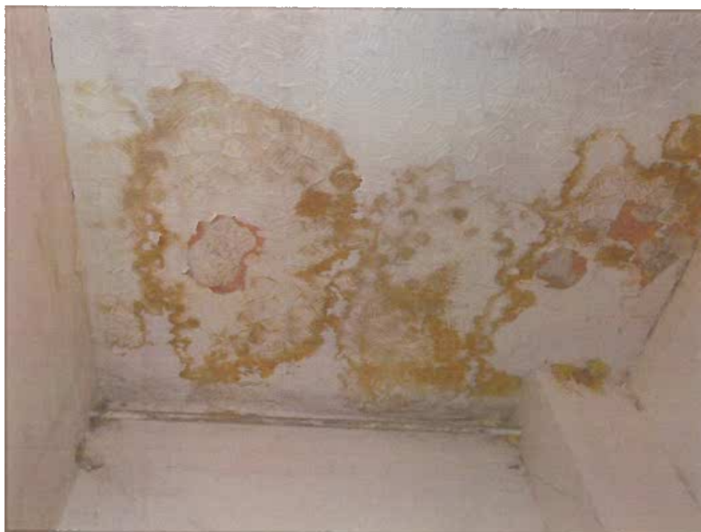
Obr. 36 Detailní pohled na vyschlou vlhkostní mapu podhledu, m.č. 116.
