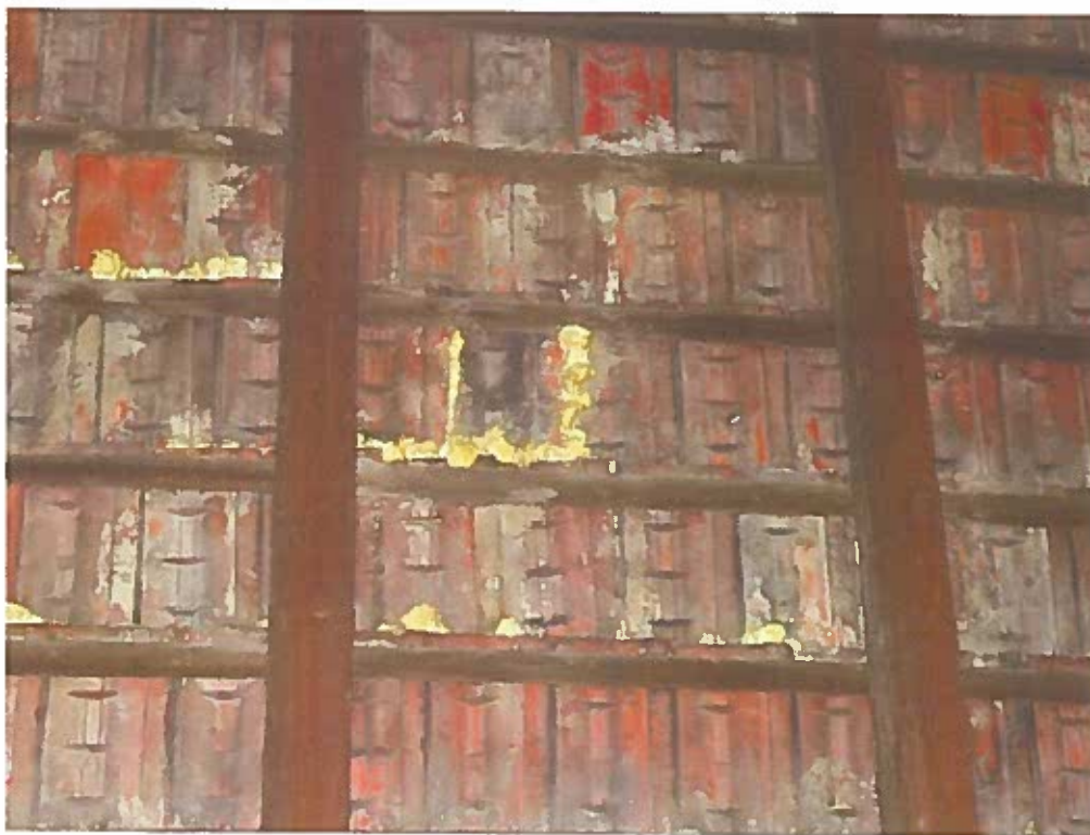
Obr. 70 Neodborné opravy taškové krytiny.
