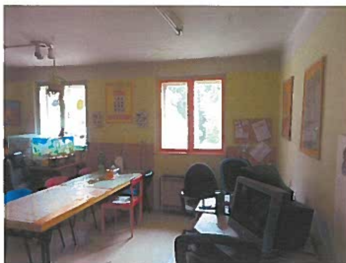
Obr. 26 Vlhkostní mapa zjištěná pod stropem místnosti v místnosti 209 Jedná se o vlhkost způsobenou zátokem přes střešní konstrukci.
