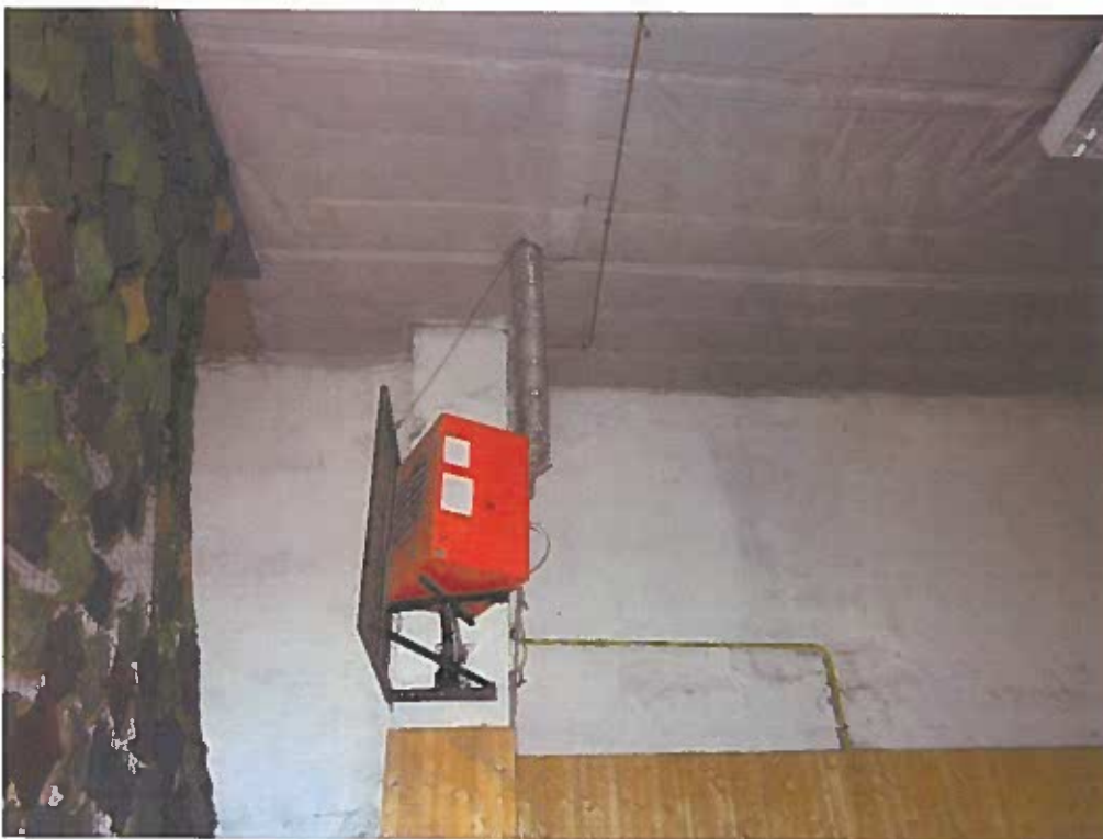
Obr. 44 Plynové topidlo v tělocvičně, nedokončený pohled z parozábrany.
