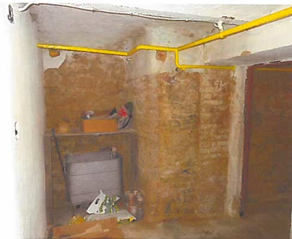
Obr. 84 Sklad sklepa Effety, vlhké smíšené zdivo.
