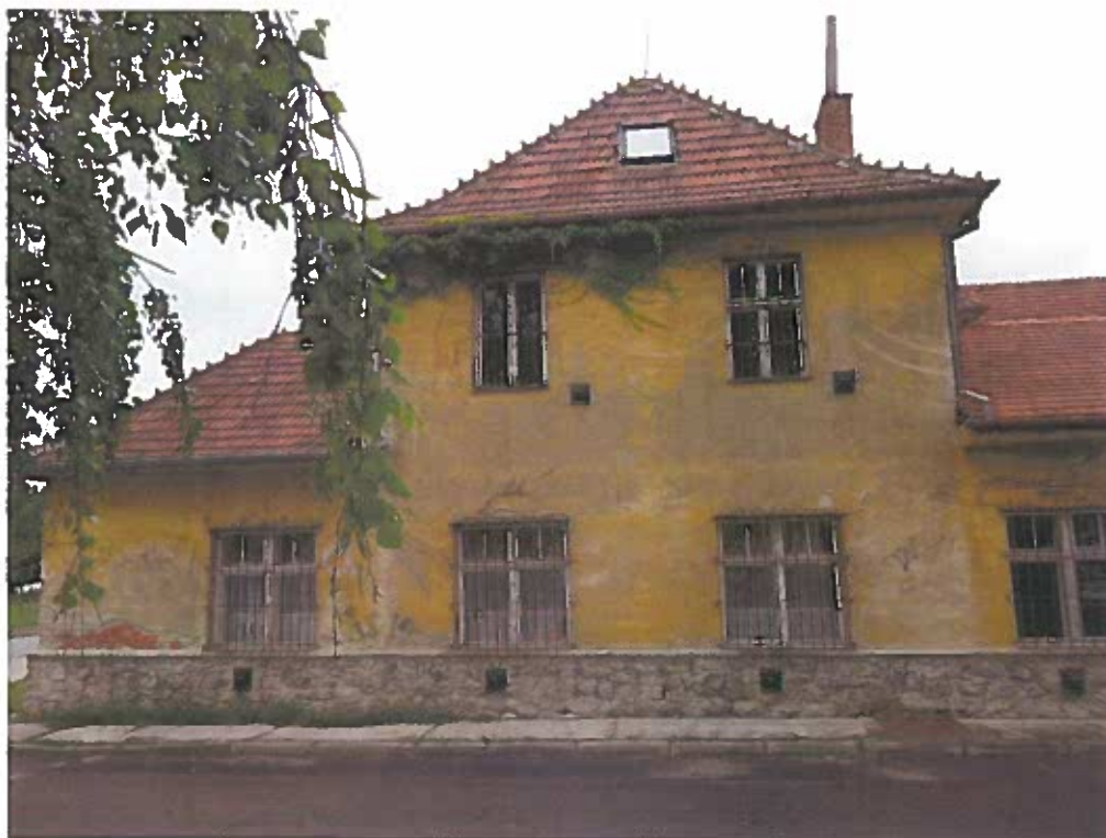
Obr. 10 Pohled na objekt Effety od ulice Leskauerova (degradace fasády).
