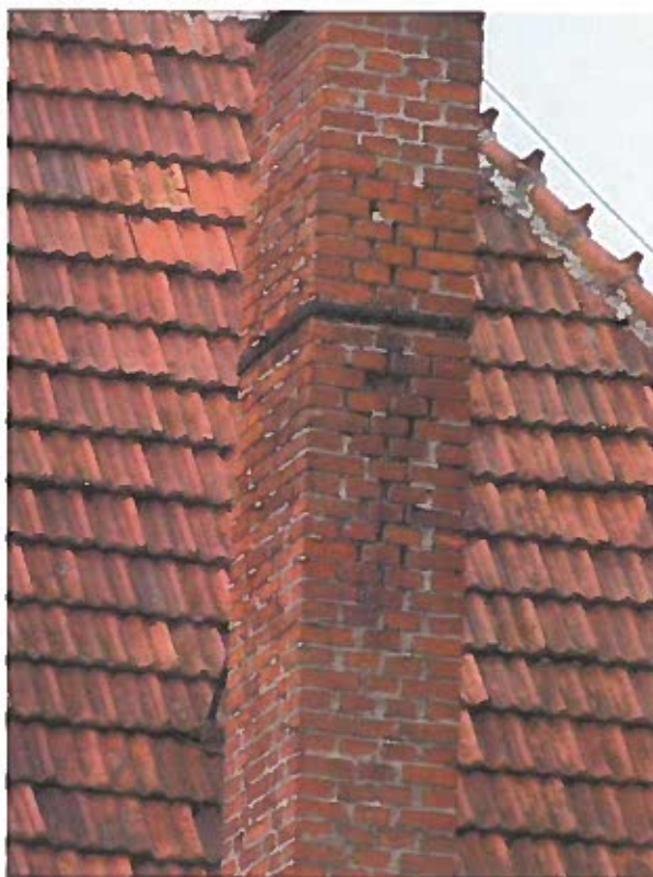
Obr. 80 Porušený vysoký komín nad Orlovnou.
