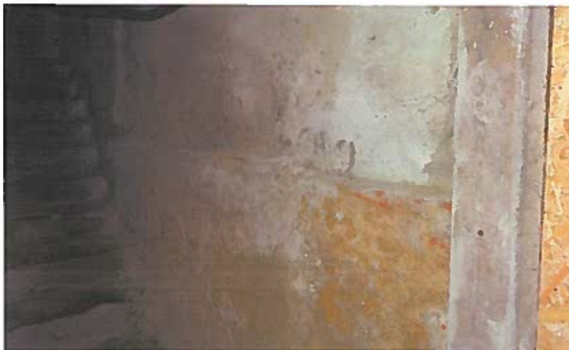
Obr. 20 Vlhkost smíšeného zdiva v chodbě se schodištěm 112
