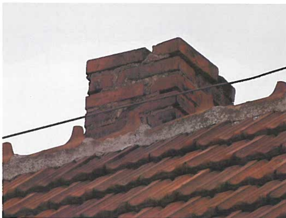
Obr. 78 Jeden z porušených kominů na části objektu Effeta..
