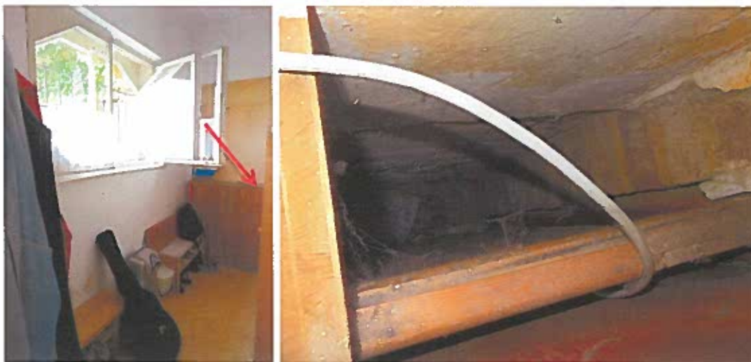
Obr. 24 Vlhkostní problémy v šatně 04 Effeta za obložením
