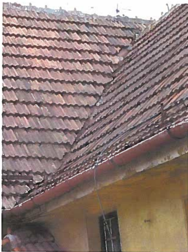
Obr. 74 Pohled na zanesené úžlabí na průniku stretch na části Effeta.
