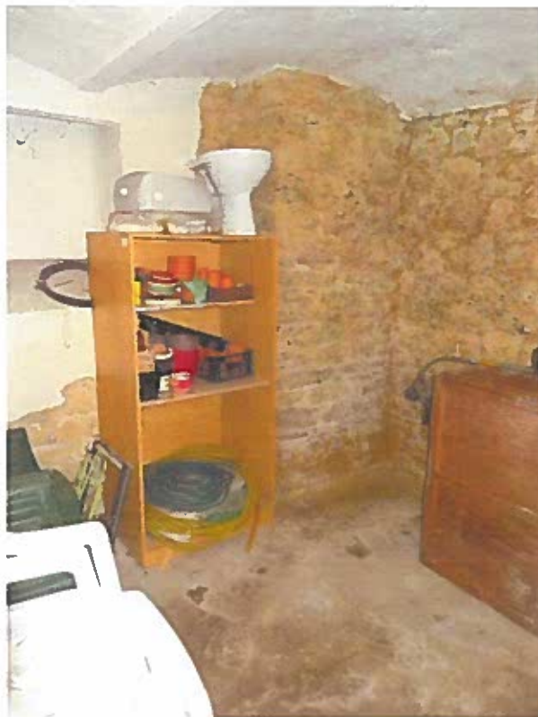
Obr. 85 Jiný pohled na vlhké smíšené zdivo skladu Effety ve sklepě.
