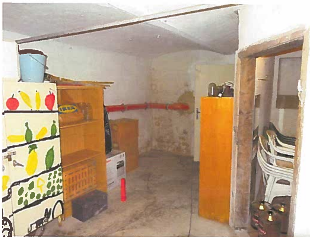
Obr. 83 Hlavní místnost sklepa v Effetě, vlhkostní mapy pod kanalizací.
