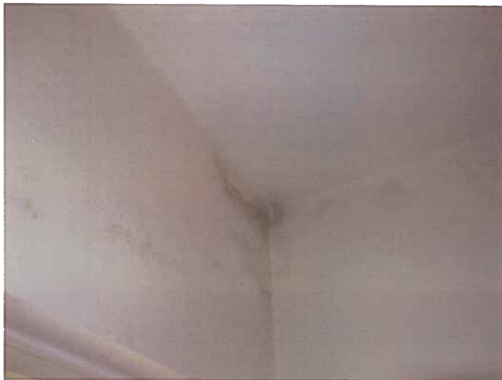
Obr. 109 Náznak plísně v rohu pod stropem m.č. 13.
