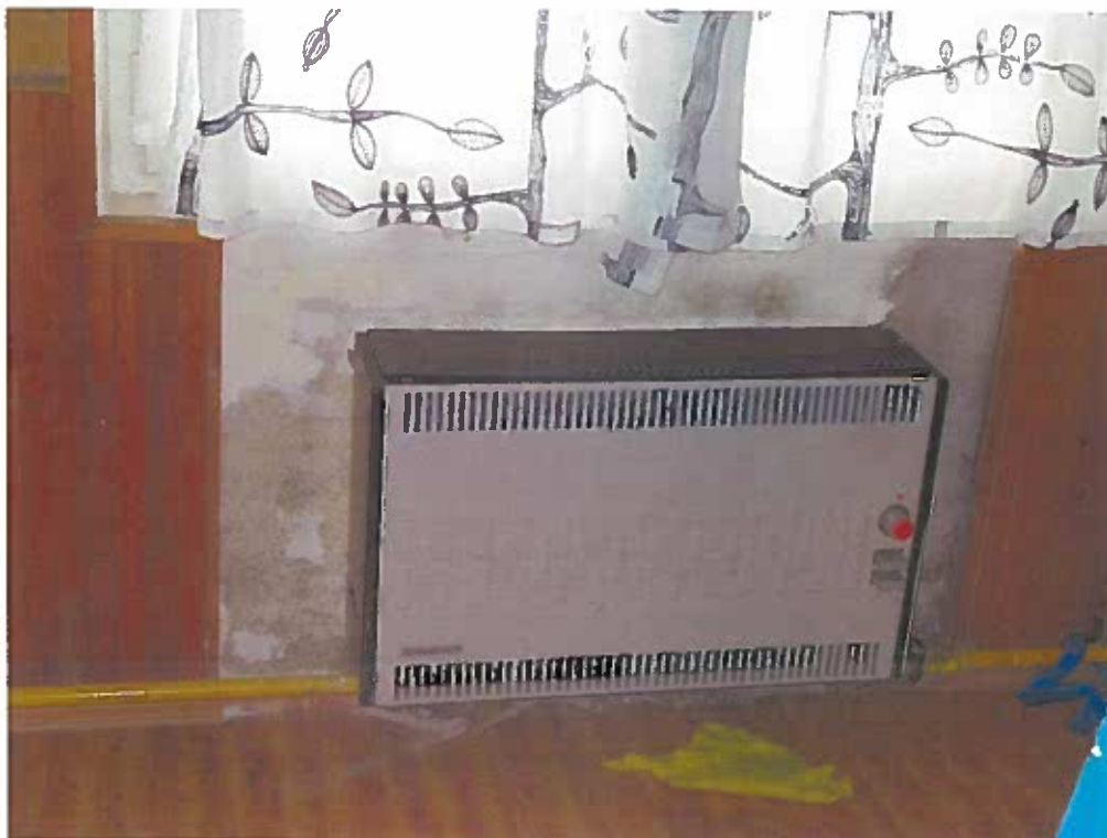
Obr. 105 Vlhkostní mapy za radiátorem pod oknem k ulici Leskauerově, m.č. 11.
