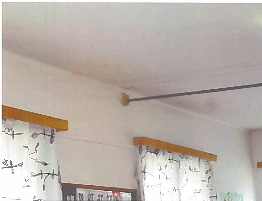
Obr. 104 Vyschlá vlhkostní mapa na styku zdiva stropu mezi okny místnost 11.
