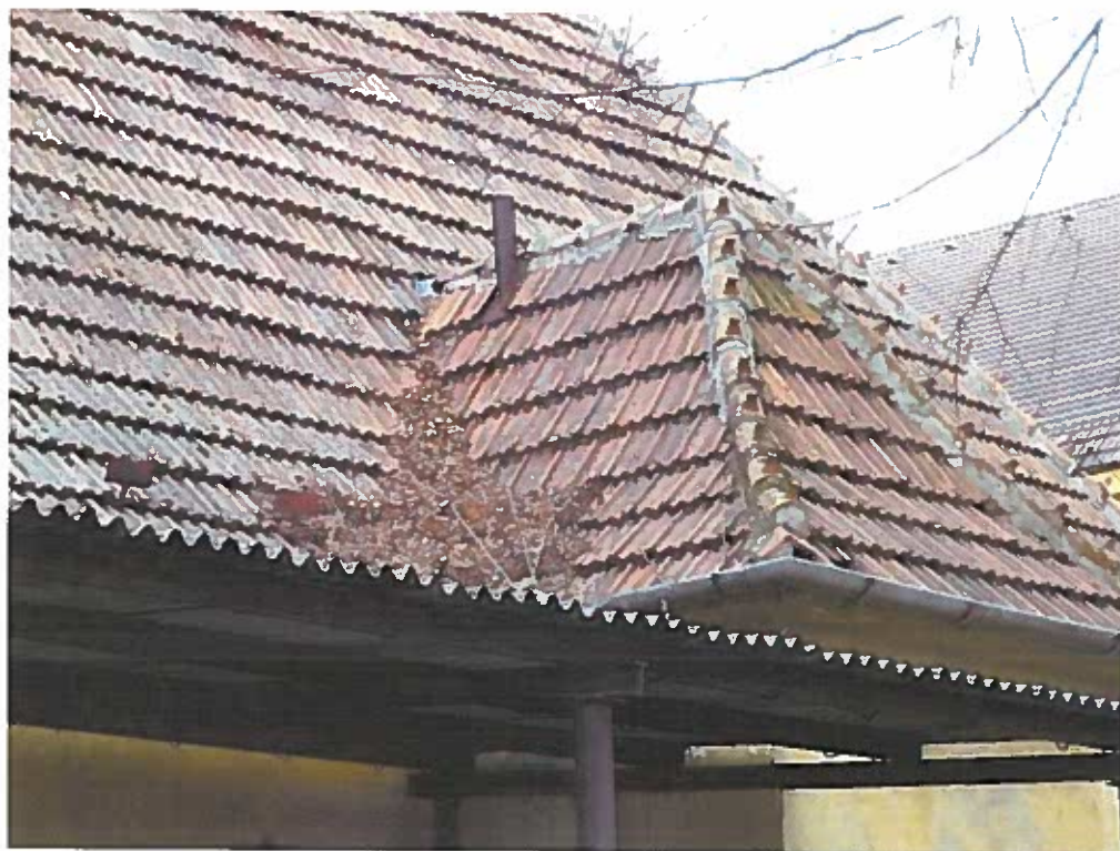
Obr. 73 Další vikýř a zanesené úžlabí na jižní části Orlovna ve dvoře.
