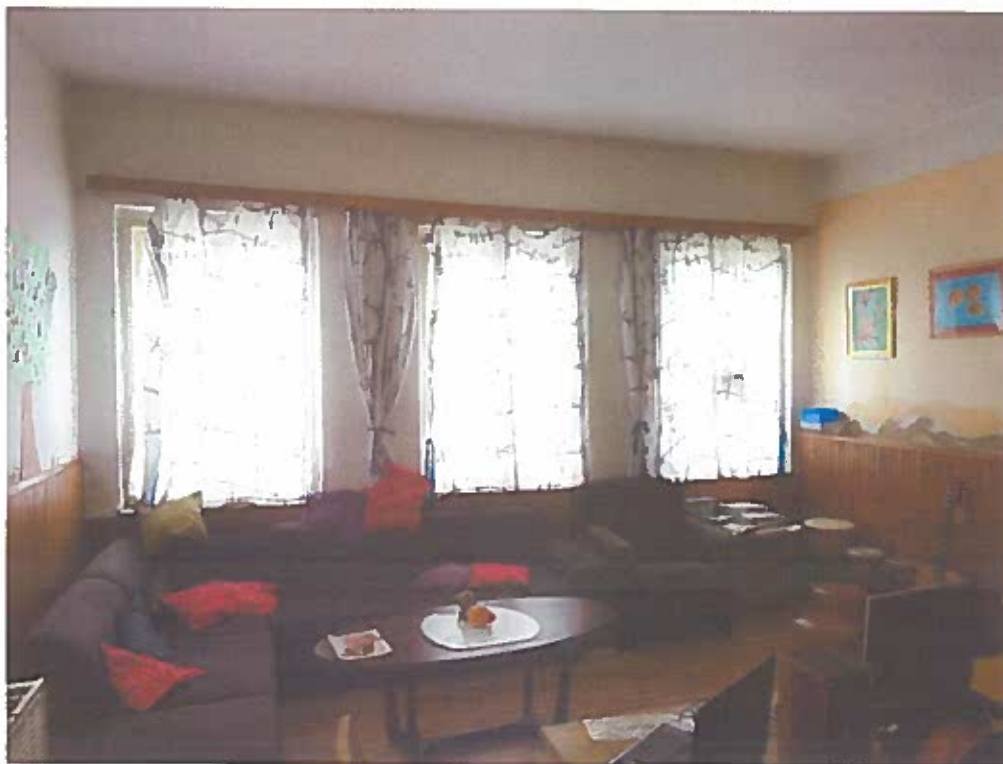
Obr. 103 Společenská místnost, jídelna č. 11, vlhkostní mapy v rozích za dřevěným obkladem zdiva.
