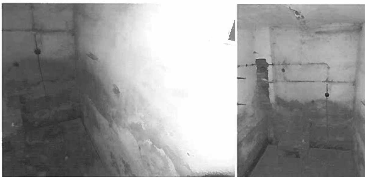
Obr. 19 Vlhkost zdiva ve skladu Orlovny v 1PP (bývalá kotelna).
