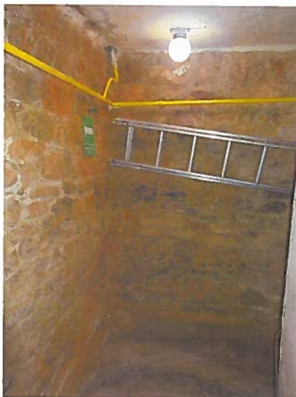
Obr. 82 Vlhké smíšené zdivo sklepa u schodů Effety.
