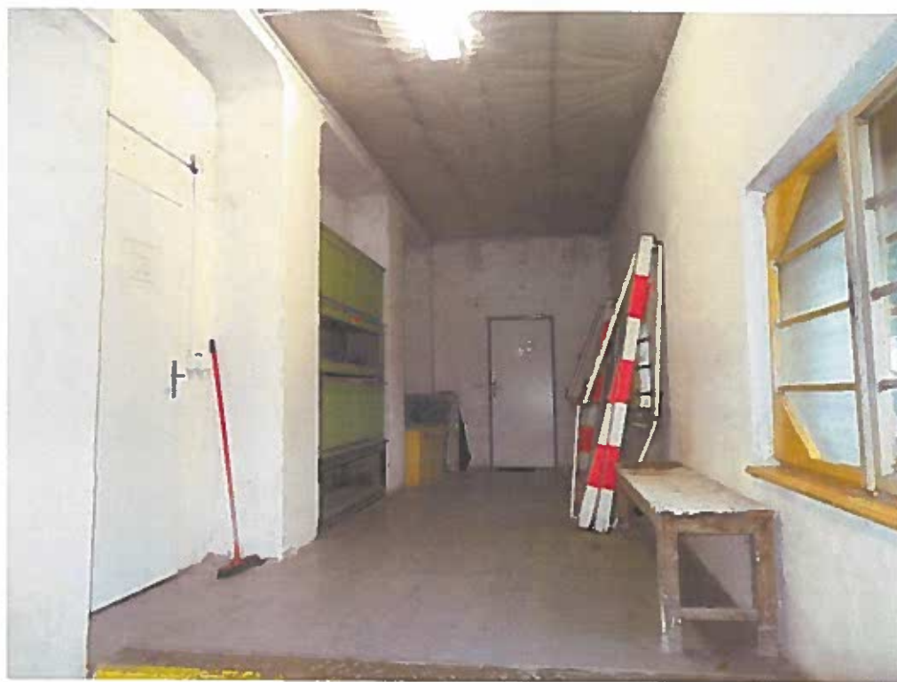
Obr. 40 Zvýšená část chodby č. 119, pohled z parozábrany.
