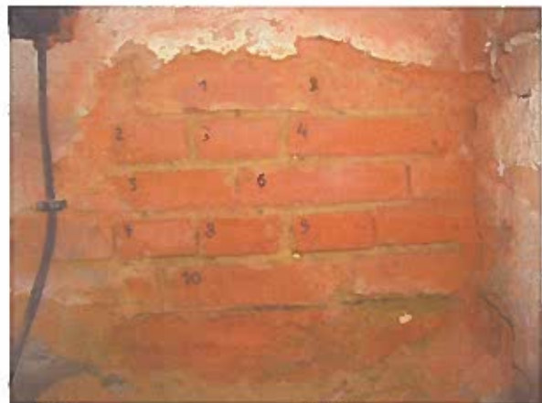
Foto 10 Detail na připravené zkušební místo Z5 s označenými zdicími prvky, na kterých byly provedeny NDT pevnostní zkoušky zdiva
