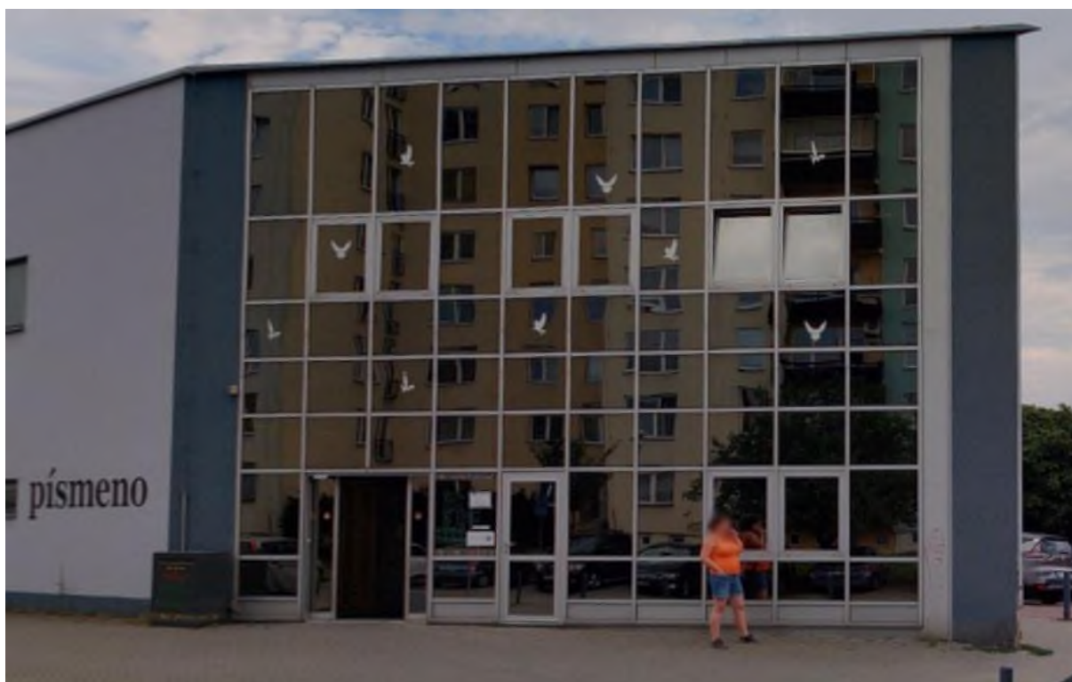
Obrázek 13: Nebezpečná prosklená plocha na budově radnice není dostatečně zabezpečena.
